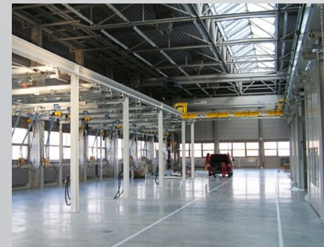
Handtransportbahn mit SPS-gesteuerten Querverschiebekränen Manual conveyor belt with SPS controlled cross displacement cranes
