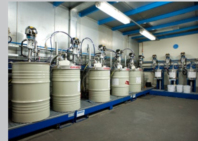
Farbversorgung aus 200l-Fässern mit Auffangwannen Paint supply system with 200l-barrels incl. collecting pans
